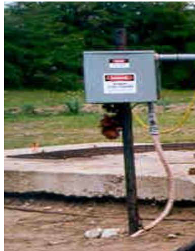
Figura 2-17. Caja de Venteo. Fuente: INTEVEP, 2005
