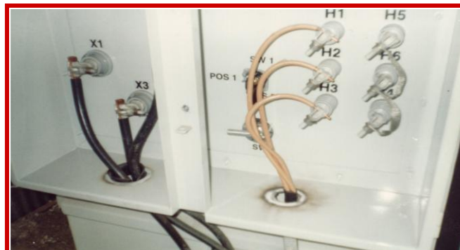
Figura 2-15. Transformador Secundario o elevador. Fuente: PDVSA 2008
